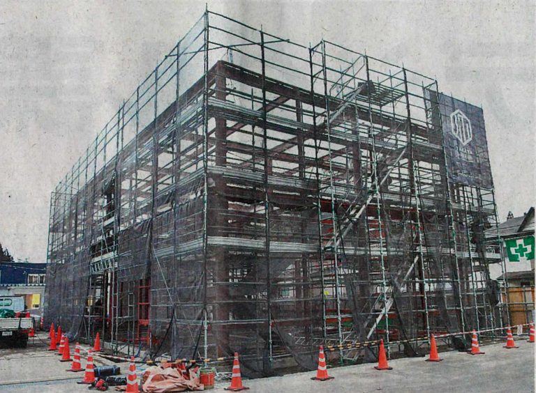
WINGが建設中の新工場。開発部門を強化し、付加価値の高い製品づくりを目指す
